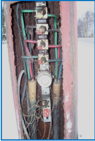
Foto č. 1 Sloupový rozvaděč v provozu
