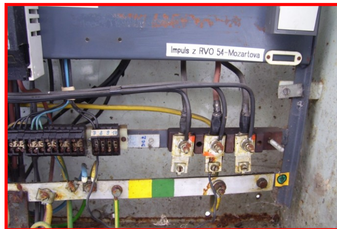
Foto č. 3 Pěkně korodující rozvaděč
