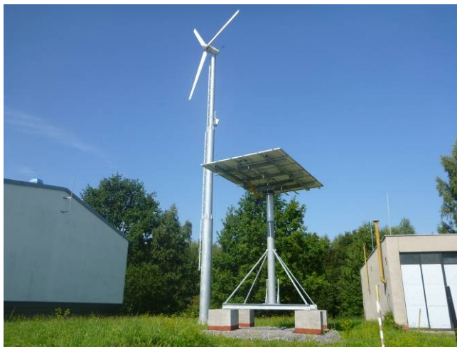
• obr. 2 Větrná a natáčecí fotovoltaická elektrárna
